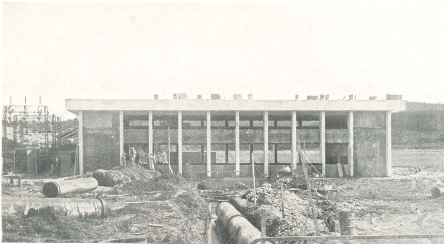
Casa de força da RP 1.
