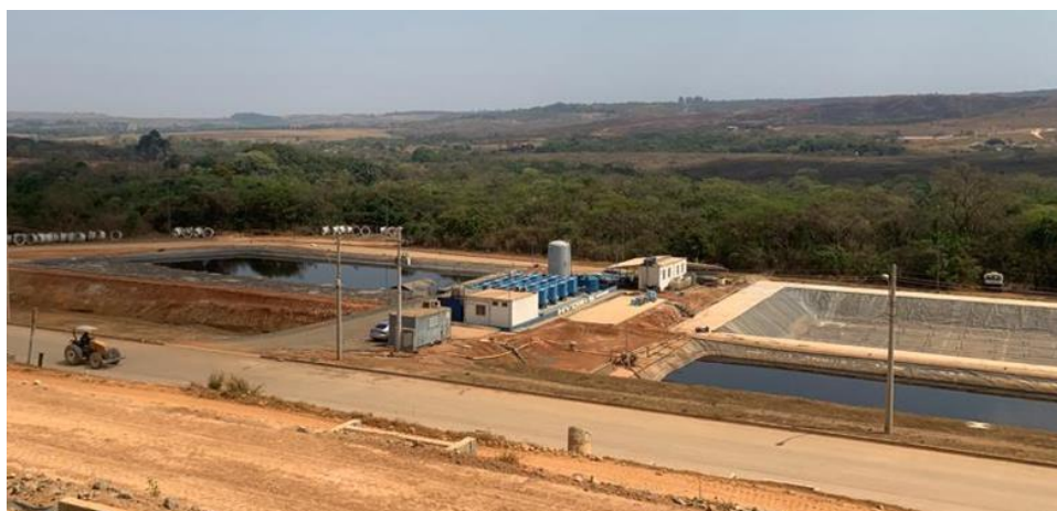
Imagem 79. Usina de tratamento de chorume do ASB. (Foto: set. 2022)
